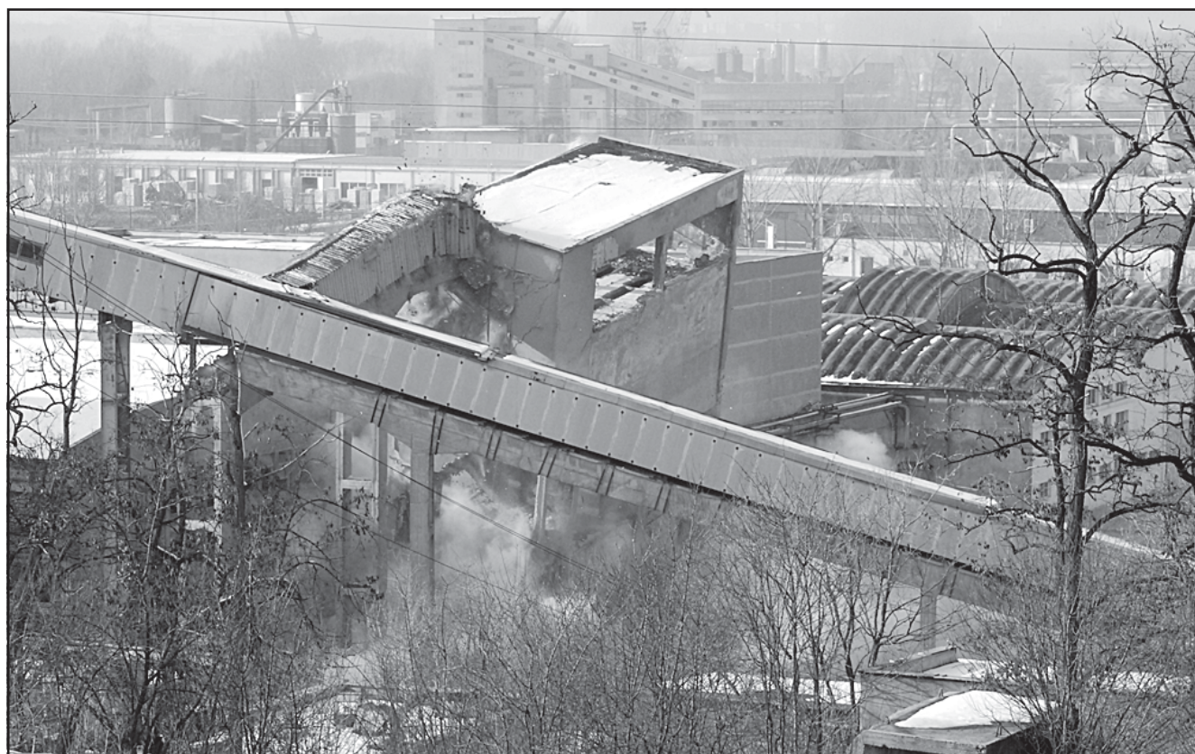
С контролиран взрив бе съборен стар бетонов възел на „Домостроене“ АД - Русе
