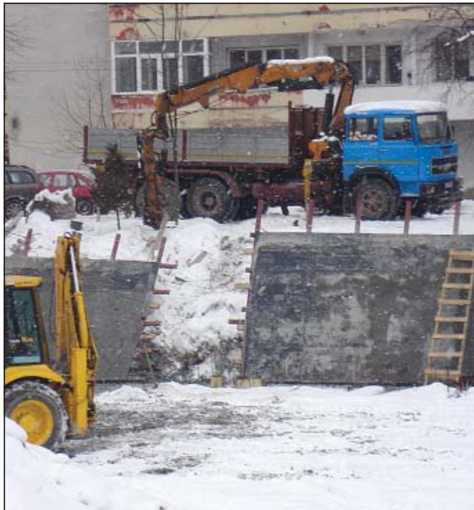
Новата подпорна стена в коритото на река Вит не може да издържи на собствената си тежест и рухна
