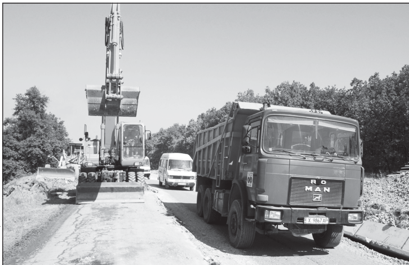
С усилено темпо и без спиране на движението от Хасково към Кърджали се извършва строежът на новия пътен участък между селата Жълти бряг и Книжовник
