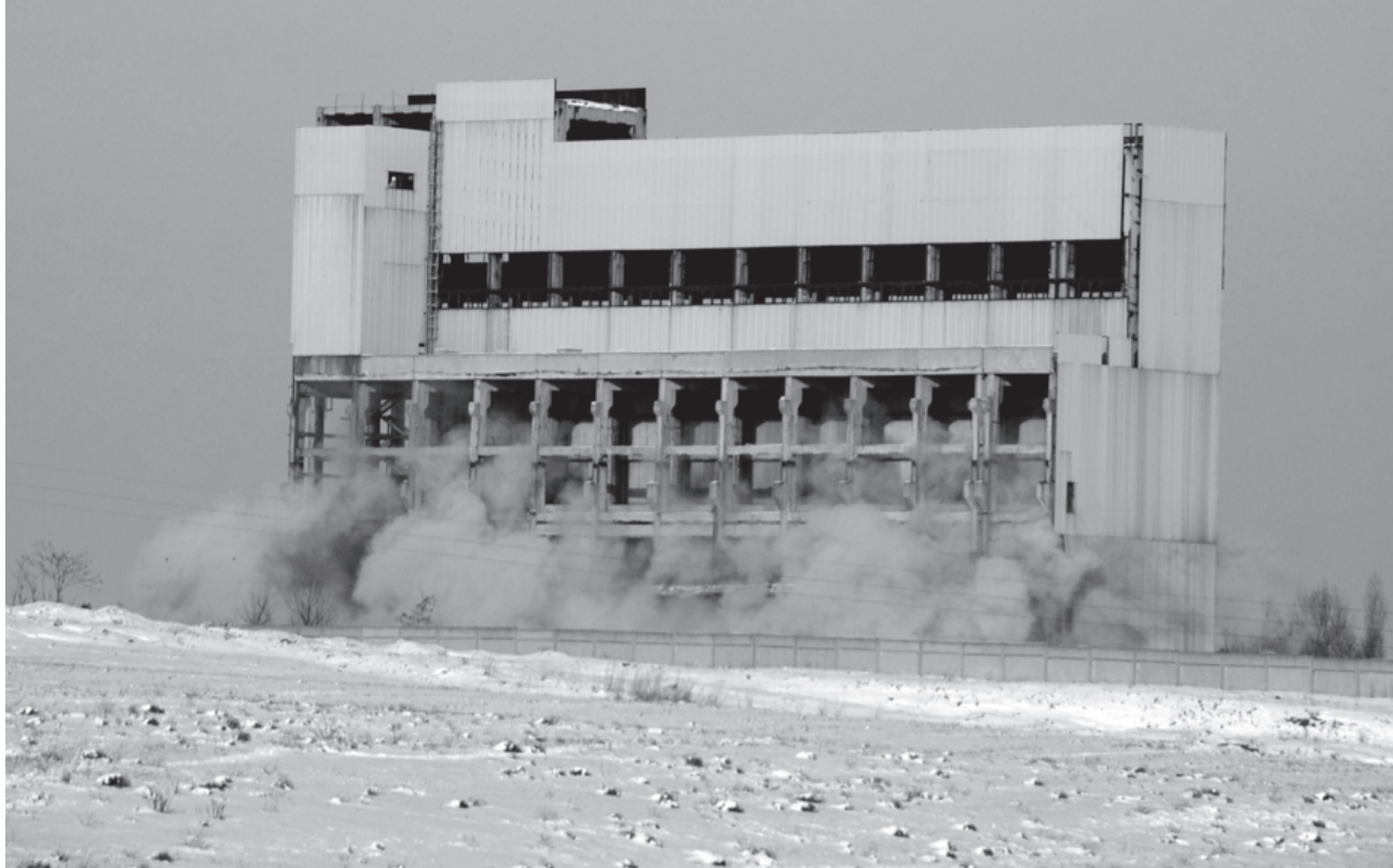
Разрушаването на стара ТЕЦ, издигаща се над Хасково, започна вчера. Бе взривен първият корпус, но поради изключително голямото количество арматура сградата не падна. Предстои доразрушаването и взривяването на големия комин. На същото място ще бъдат построени две газови централи
